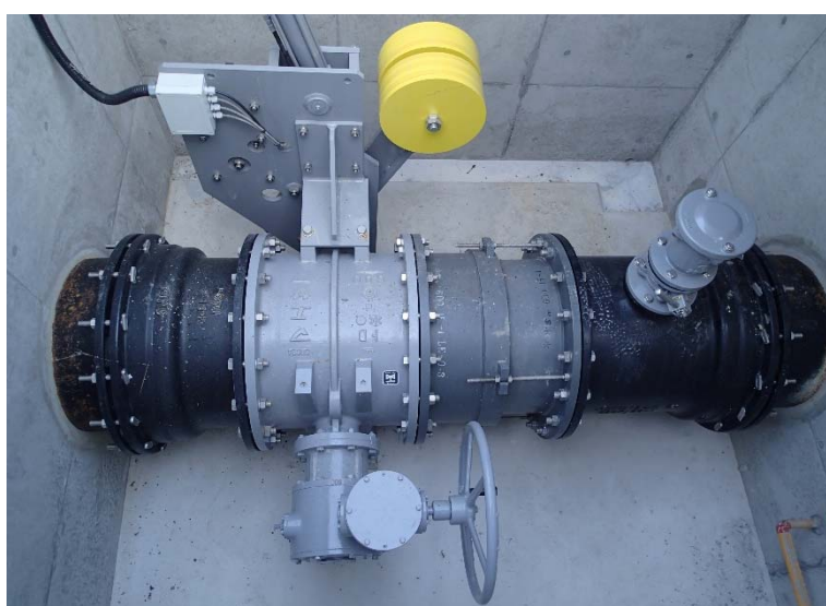
緊急遮断弁（上粕配水池）
