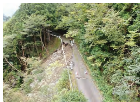
台風14号に伴う被災状況（城師大橋別子山線）
