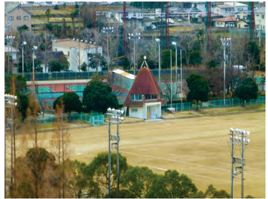
伊予三島運動公園照明設備
