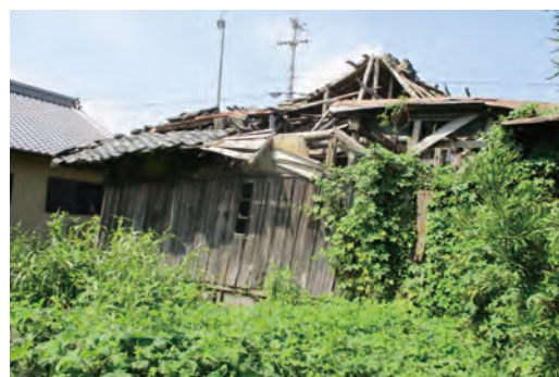
老朽化した危険な空き家
