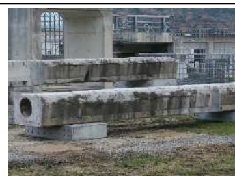
図3.3 四国技術事務所にて損傷桁の検証
