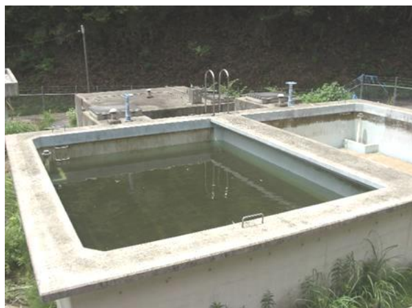
北東部浄水場
