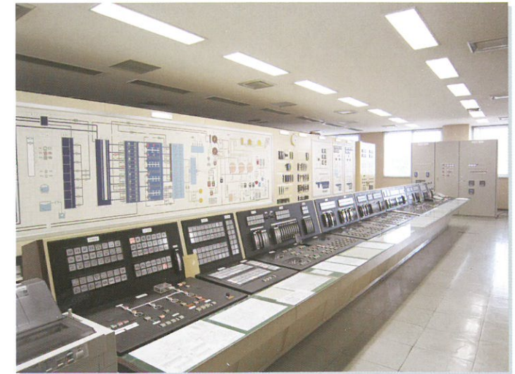
中央監視室(三島浄化センター)
