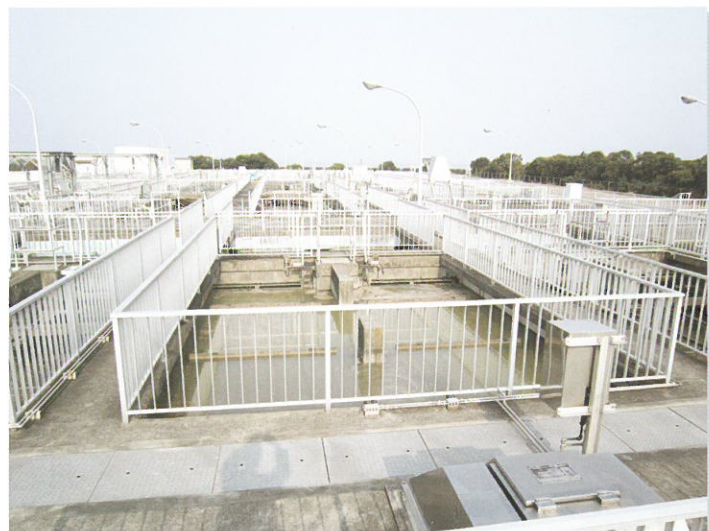
最初沈殿池(三島浄化センター)
