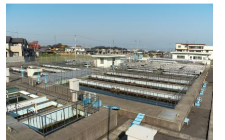
中田井浄水場
