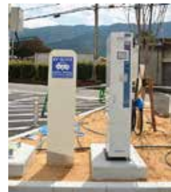
▲電気自動車急速充電器（東駐車場に設置）
