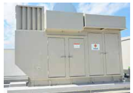
▲災害時に必要な電気を供給するための非常用自家発電設備
