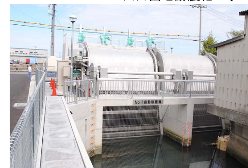
宮川ポンプ場 19
