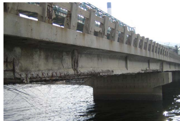
通行止めとなっている港橋
