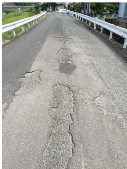
経年劣化等により路面が痛みが進行している市道の様子（市道：本町川関線）
