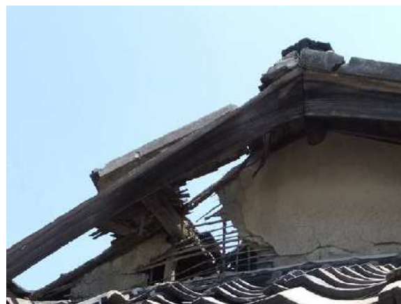
市内の老朽危険空家等の状況
