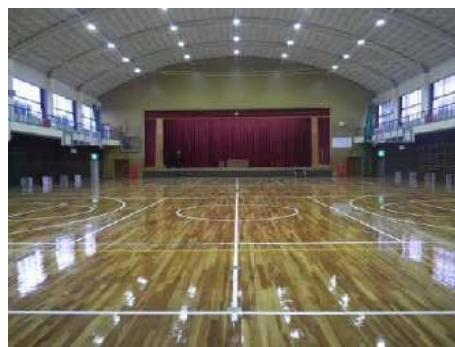
非構造部材耐震化工事が完了した体育館 (三島西中学校)
