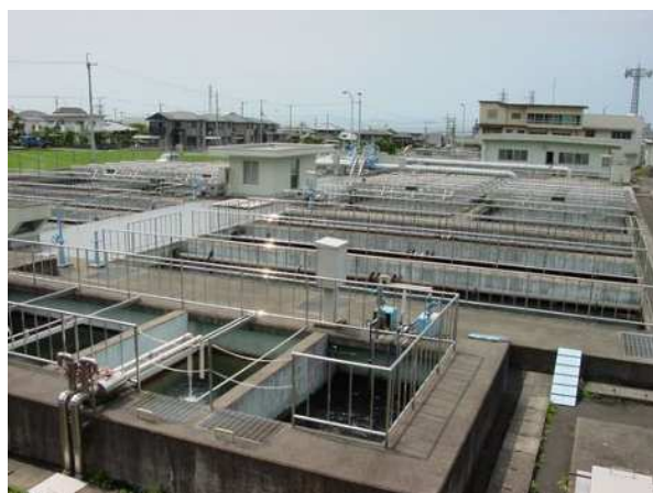
浄水施設(沈澱池)
