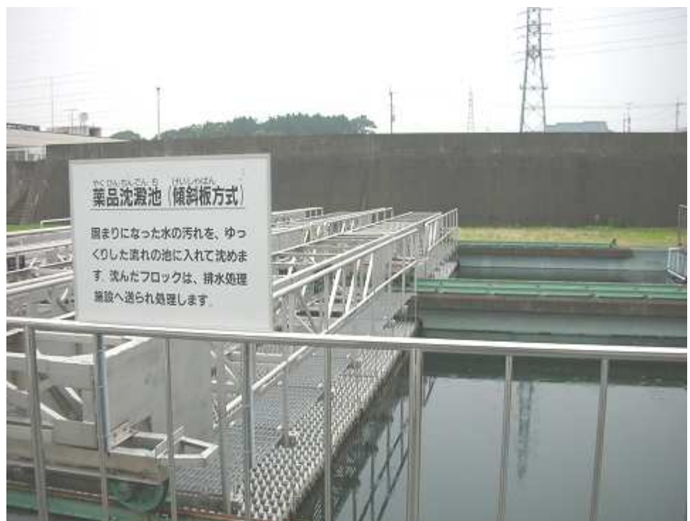
沈澱池（更新前）
