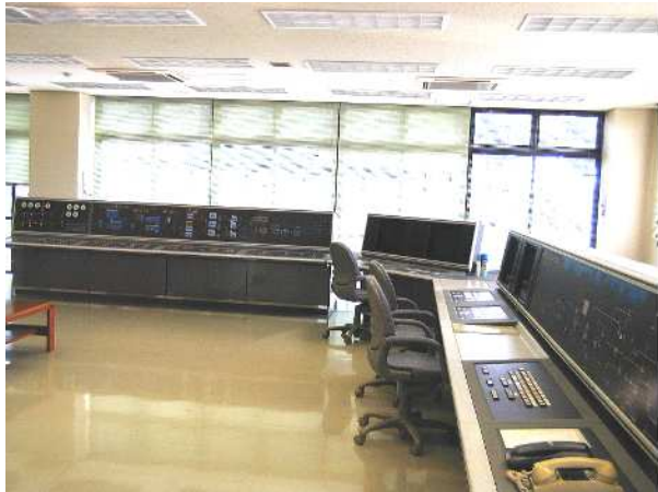
中央管理室 (更新前)
