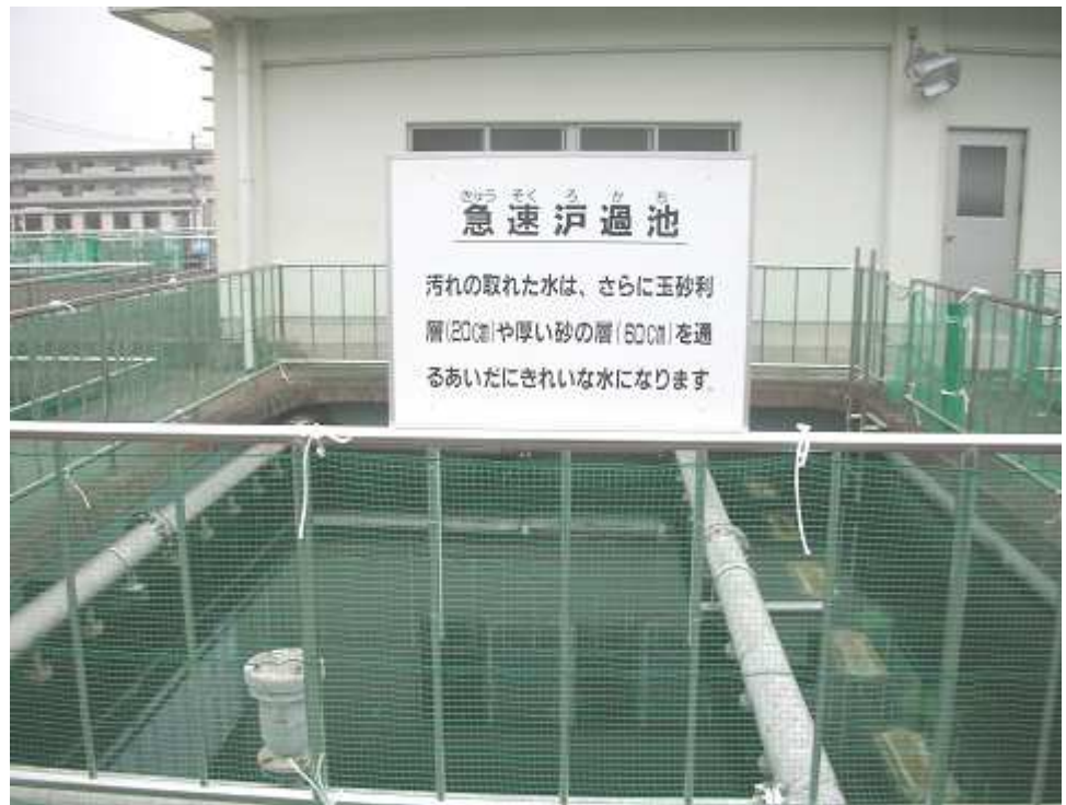
急速ろ過池 (更新前)
