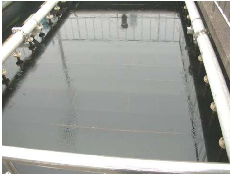
急速ろ過池 (更新前)
