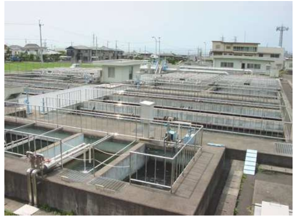
浄水施設 (沈澱池) (更新前)
