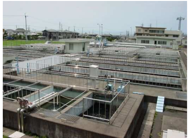
浄水施設(沈澱池)
