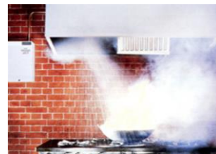
自動消火装置作動状況
