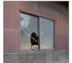
窓が割れた管理不全空家
